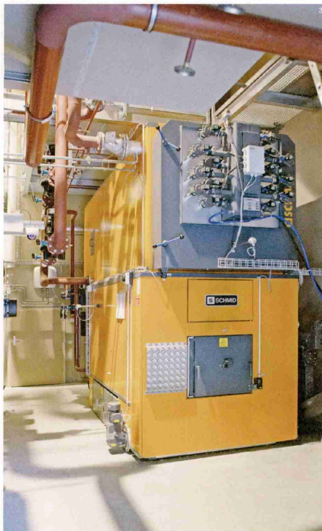
3 Inbetriebnahme der neuen Heizzentrale im Oktober 2014
