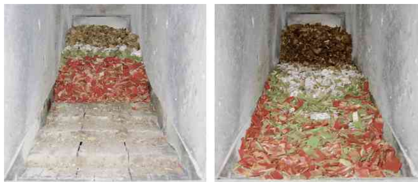
Blick in die Brennkammer einer Holzfeuerung (hier im kalten Zustand). Die Hackschnitzel kommen hinten in die Brennkammer und werden durch den treppenförmigen Vorschubrost nach vorn transportiert und in dieser Zeit durch Vergasung thermisch zersetzt. Links: Ausgangszustand von übereinander liegenden Schichten aus (eingefärbten) Hackschnitzeln. Rechts: Endzustand nach Transport durch Rostbewegung.
