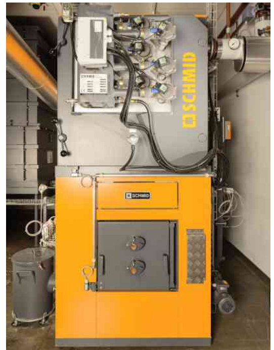
Mit einer Testanlage mit 150 kW Leistung untersuchen Wissenschaftler an der Hochschule Luzern, wie sich die Verbrennungsvorgänge in mittelgrossen Holzheizungen optimieren lassen.
